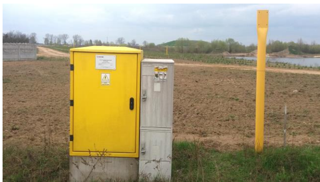
Fotografia 15. Naziemna infrastruktura gazociągu Fot. własna 14.04.2016
